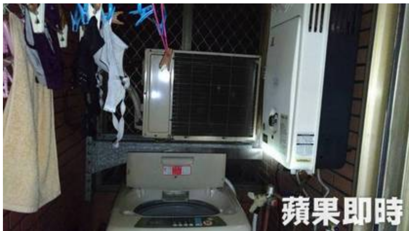
警消發現熱水器裝設在陽台，還裝設紗窗未保持通風，疑因此造成一氧化碳無法排出。翻攝畫面
