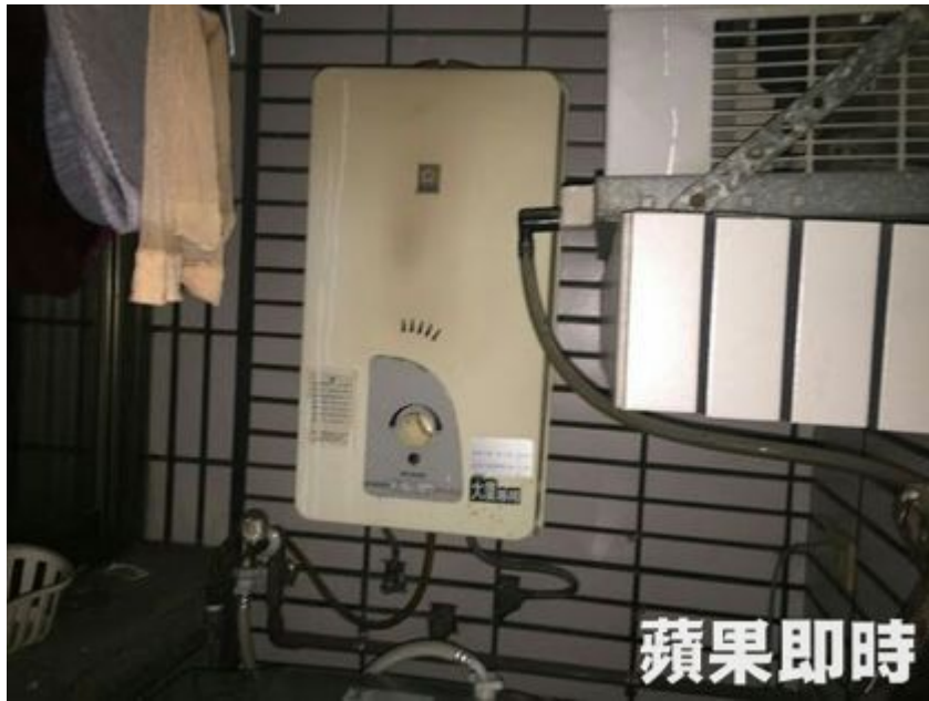
大隆路中毒案住戶裝設的半密閉自然排氣式熱水器，未裝設排氣管，且現已禁止安裝。資料畫面
